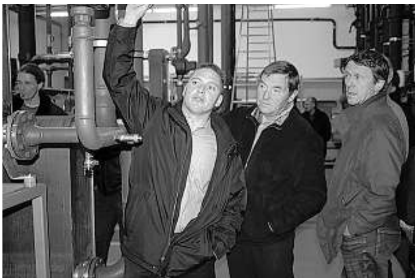
Umweltbewusste Apparatur: «Hausherr» Remo Romer (links) erklärt seinen Gästen die Funktion der Wärmerückgewinnungs-Anlage. Bild Renate Ammann
